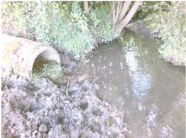
Exutoire de drain et abreuvoir sauvage
